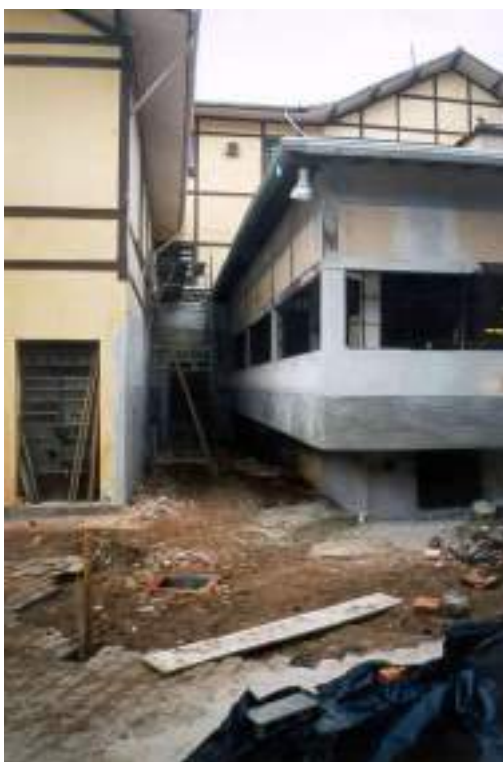
Figura 36. Início das demolições das estruturas provisórias do local onde atualmente encontra-se a saída do Aquário Água Branca (Foto: 2004).
