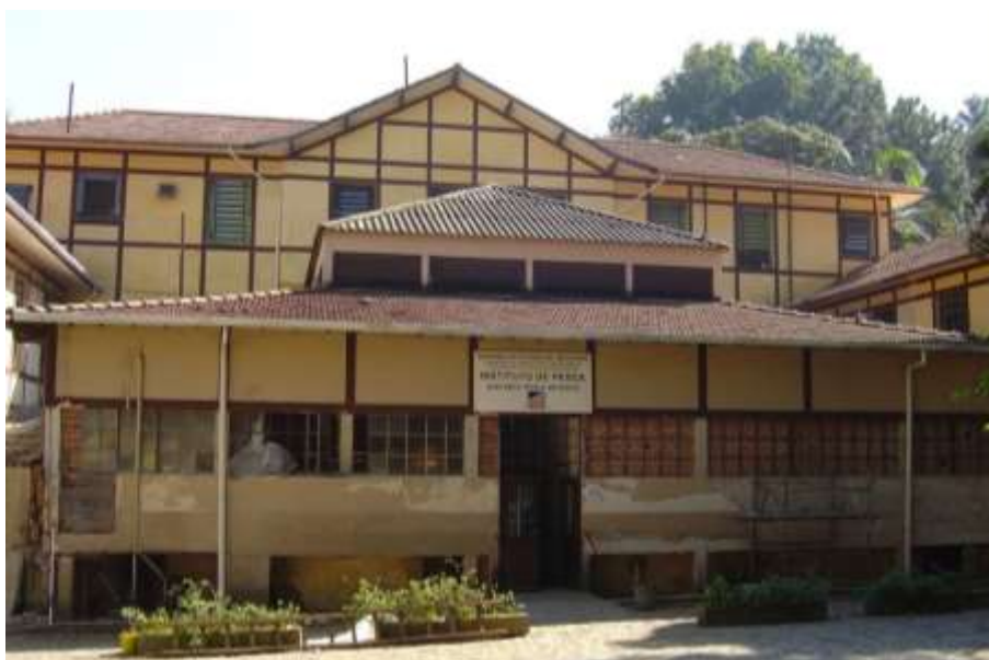
Figura 31. Fachada principal do aquário e suas estruturas provisórias como a entrada e os vitrôs emparedados (Foto: 2004).
